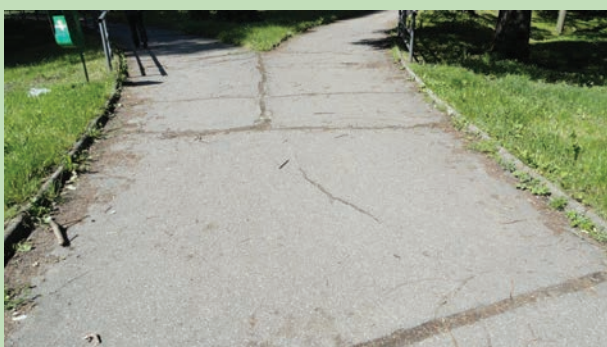
Chodník u vítkovického nádraží už toho měl hodně za sebou.
