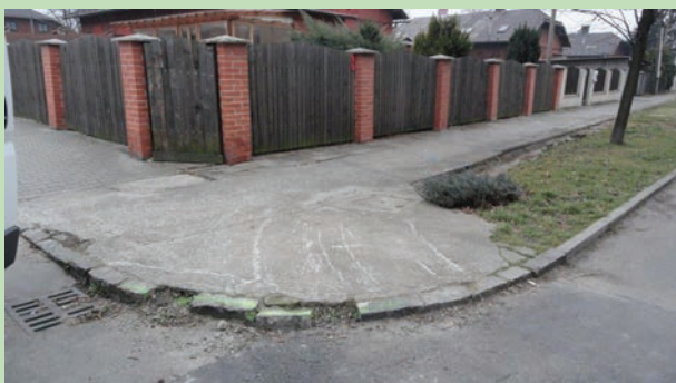
Chodník v Erbenově ulici před opravou...
